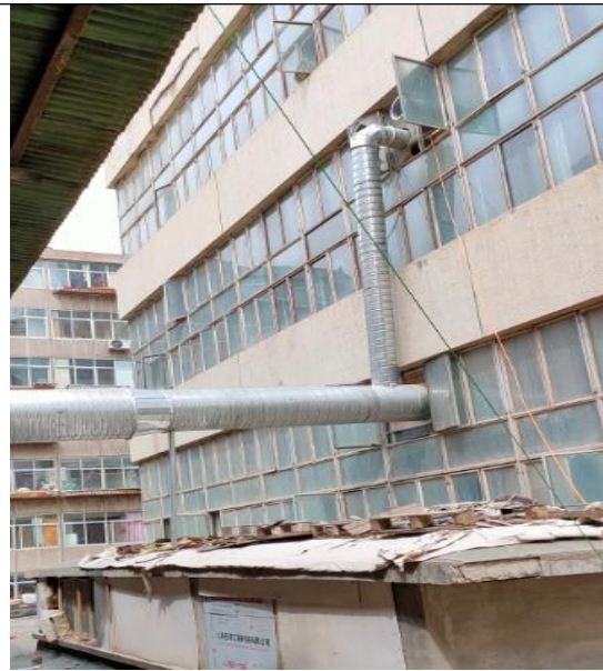
车间外废气收集管道
