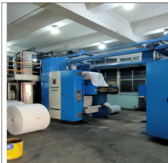
印报车间集气罩+收集管道
