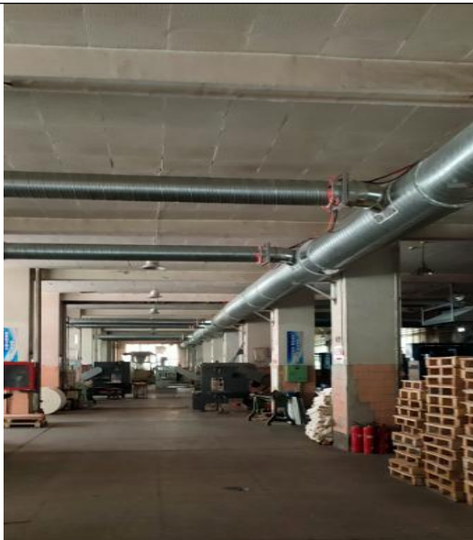
车间内废气收集管道
