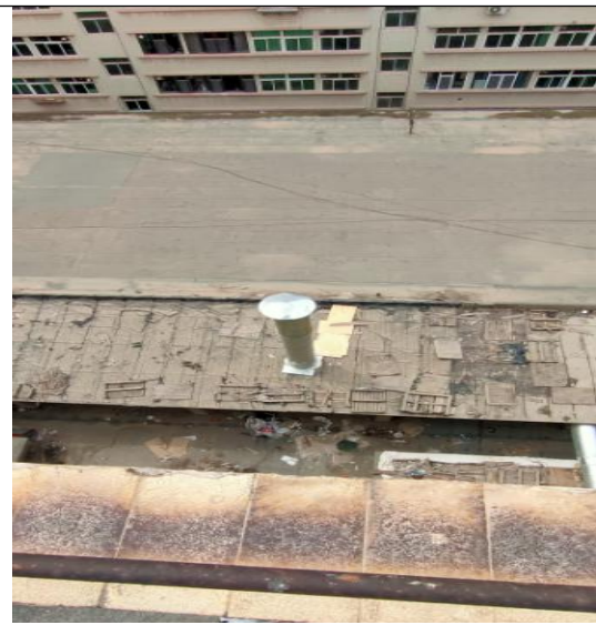
排气筒（俯视图）
