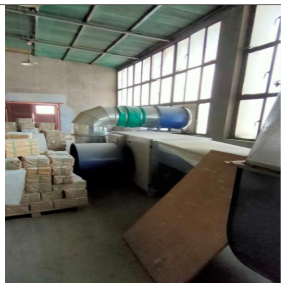
印报车间活性炭吸附处理装置
