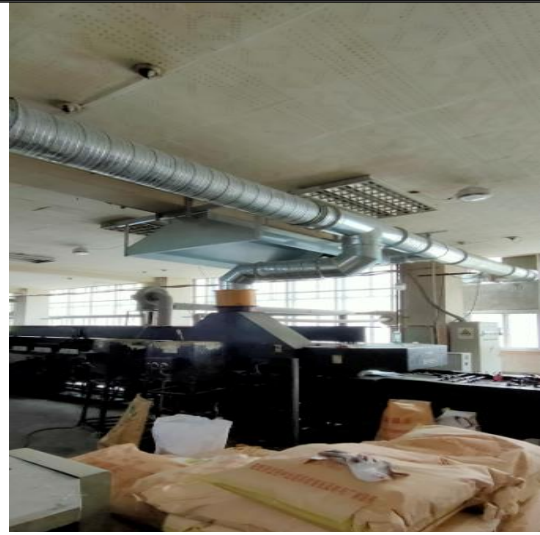
图书装订车间集气罩+管道
