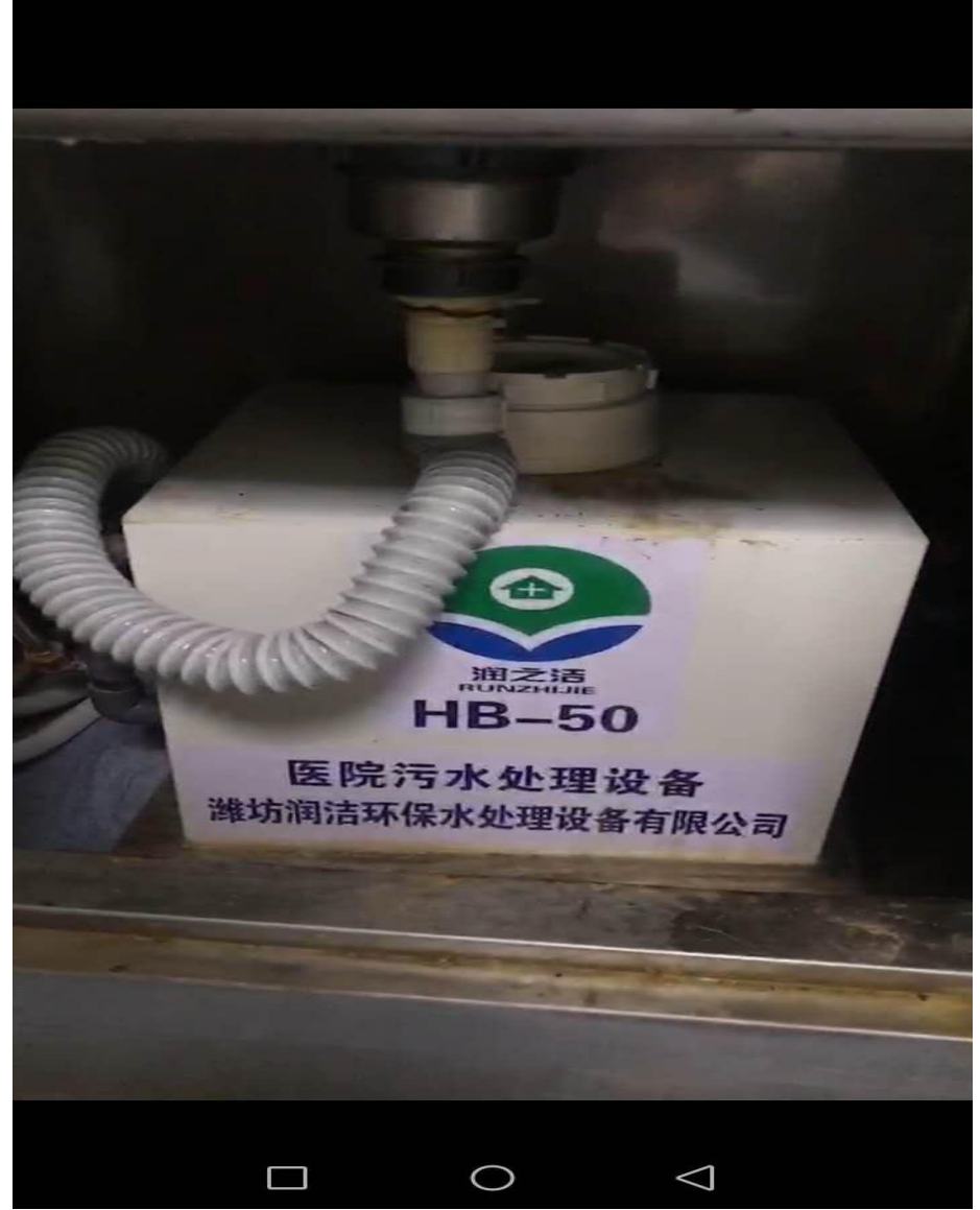
污水处理设施
