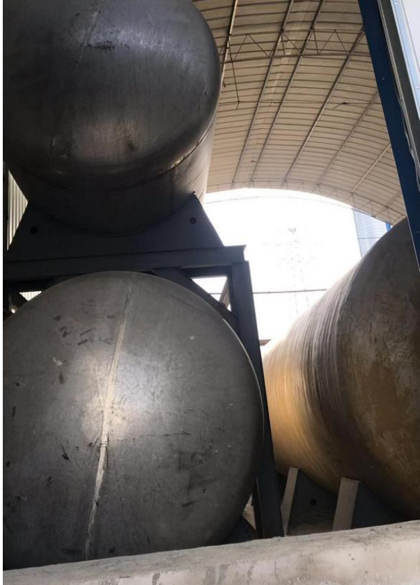
甲醇水溶液储罐
